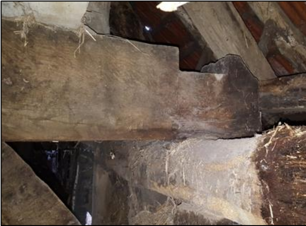
Abb. 3: Deckenbalken mit Aufnahme für die Sparrenschwelle in der ursprünglich vorgesehenen Verzimderung. Dahinter (rechts) die tatsächlich ausgeführte Sparrenschwelle
